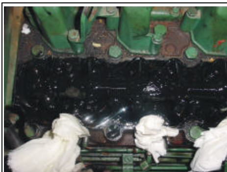
Volvo Penta Dieselmotor før innvendig motorvask
